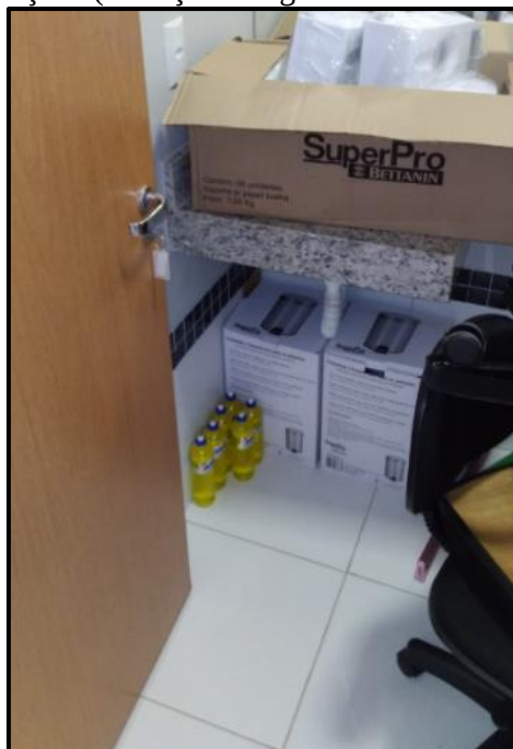
Figura 10. Sala 1702 Lavabo (Décimo Oitavo Andar). Deverá ser realizada a remoção do piso e barrado cerâmico para instalação de novo revestimento; remoção de bancada com cuba para reinstalação. (Serviço análogo na sala 1703 - Lavabo)
