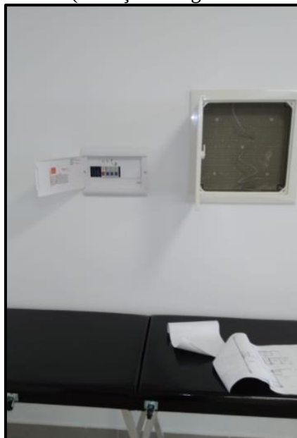
Figura 7. Sala 1702 (Décimo Oitavo Andar). Quadros de distribuição que deverão ser removidos para reposicionamento devido a demolição da alvenaria para ampliação dos banheiros. (Serviço análogo na sala 1703)
