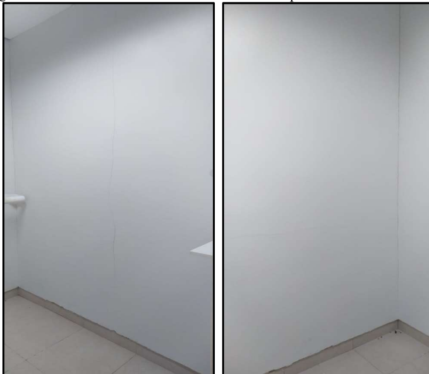
Figura 5 e 6. Paredes fissuradas a serem emassadas e pintadas na sala Raio X 01.
