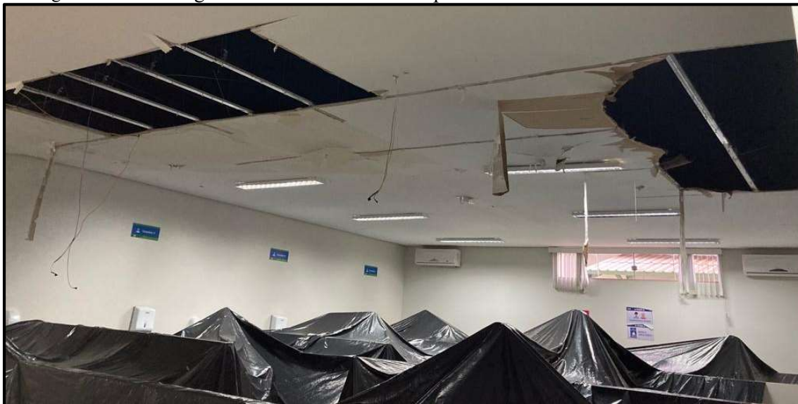
Figura 10. Forro de gesso acartonado danificado pela chuva a ser substituído no BOX 03.
