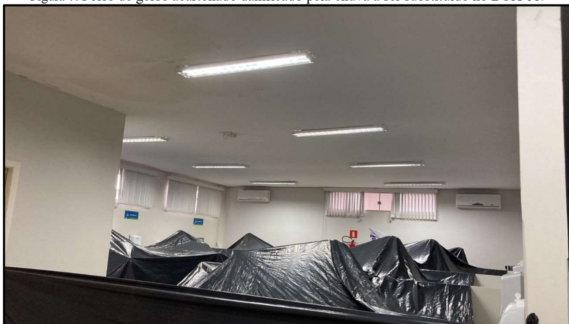
Figura 7. Forro de gesso acartonado danificado pela chuva a ser substituído no BOX 01.
