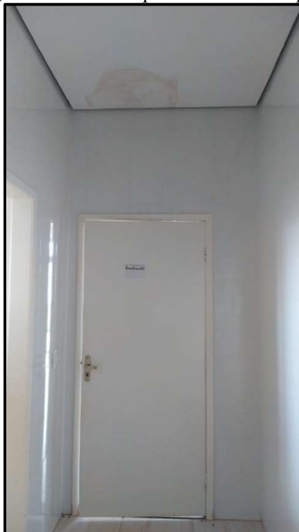
Figura 3. Forro de gesso acartonado que deverá receber pintura no BWC 01.
