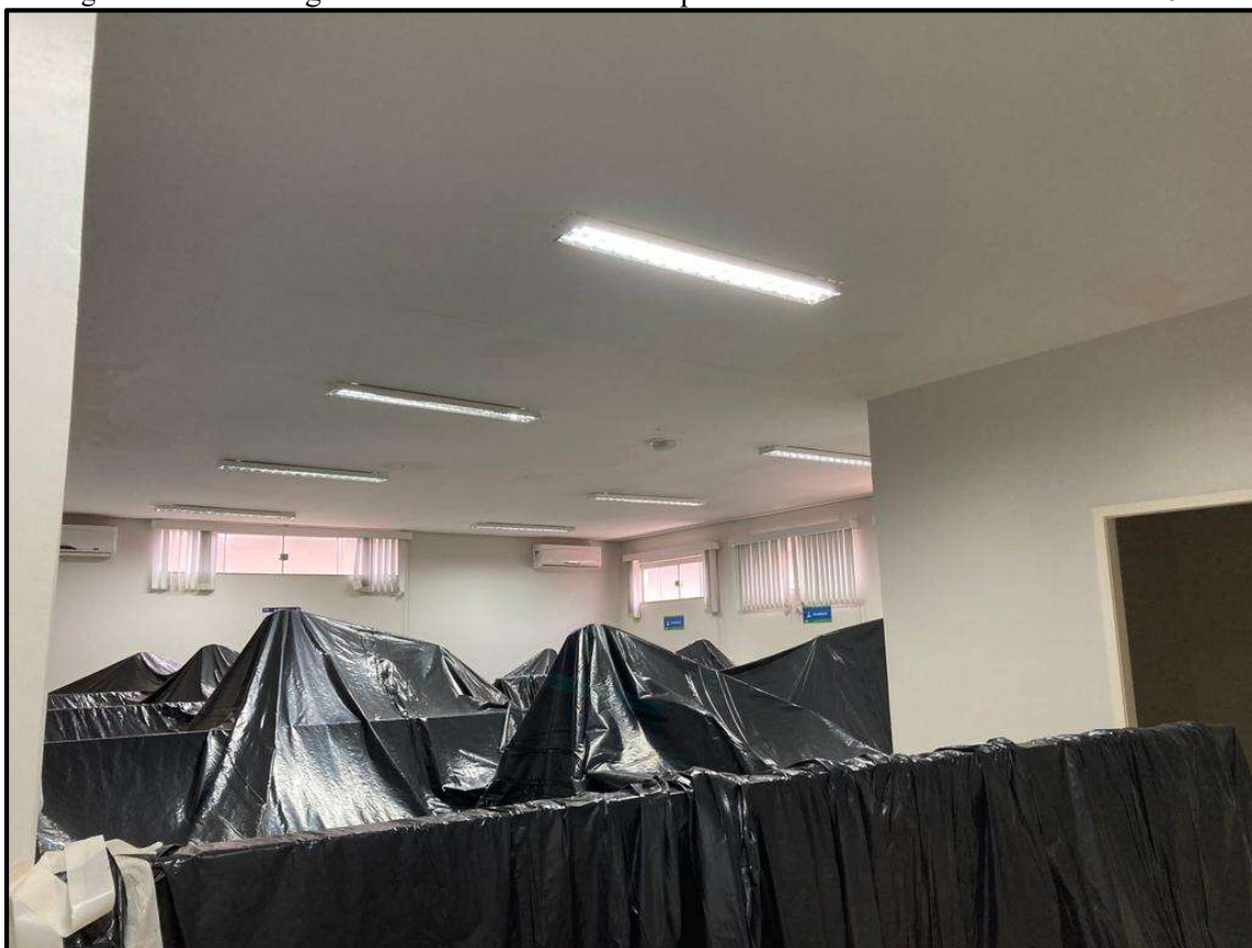
Figura 11. Forro de gesso acartonado danificado pela chuva a ser substituído no BOX 04.
