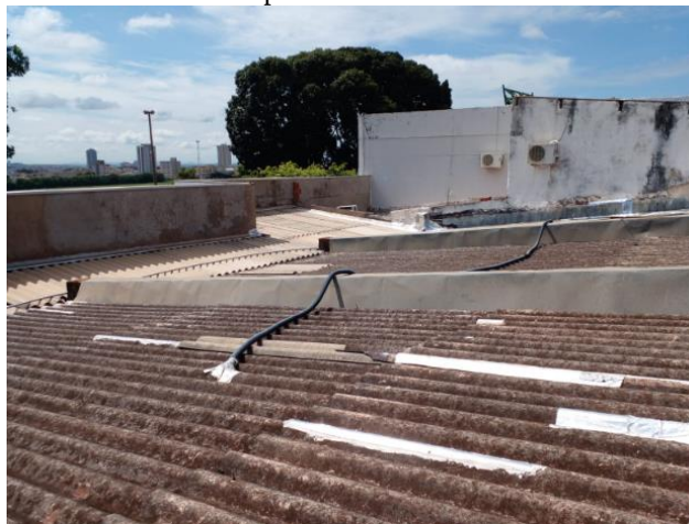
Figura 6. Cobertura atual a ser removida para inclusão da estrutura do telhado e trocas das telhas.
