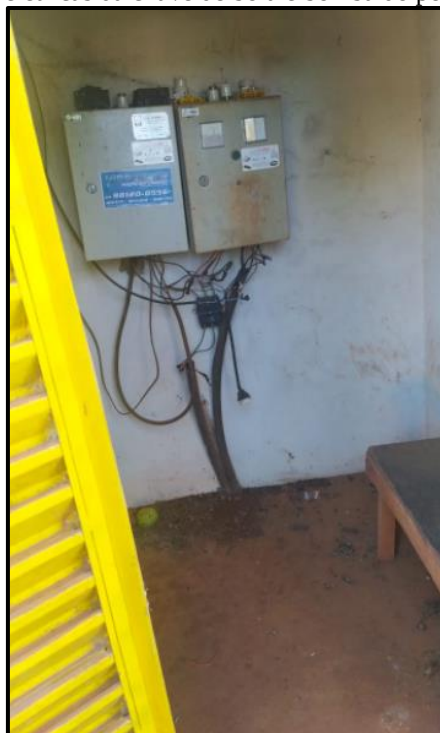
Figura 4. Instalações elétricas da chave de bóia e bomba do poço artesiano existente.
